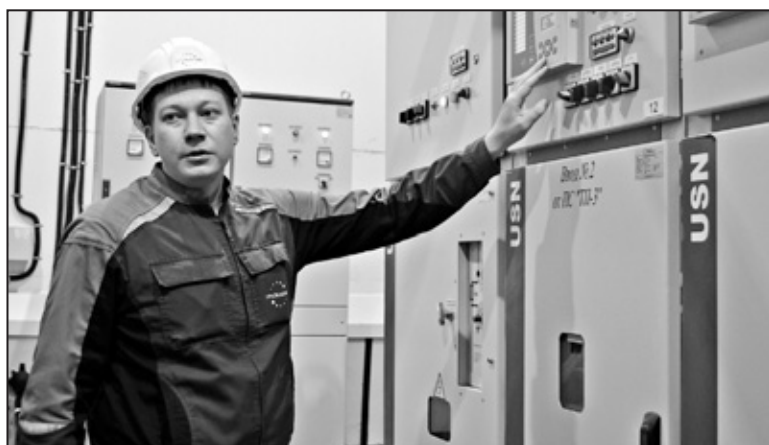
Кирилл Антипин знакомит с оборудованием помещения распределительного устройства, откуда электроэнергия в 6 тысяч вольт распределяется по подстанциям.
