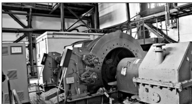
Новая подъёмная машина – современная и высокотехнологичная.
