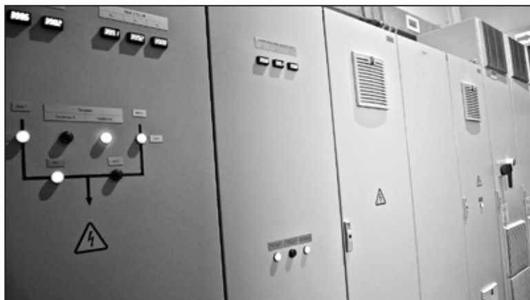
Помещение тиристорной станции, где находится преобразователь, который меняет частоту в сети и позволяет регулировать скорость движения машины от 0,1 метра в секунду до проектных 6,5 метра в секунду.
