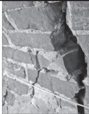
На старинной кладке Дома воеводы появились огромные трещины
