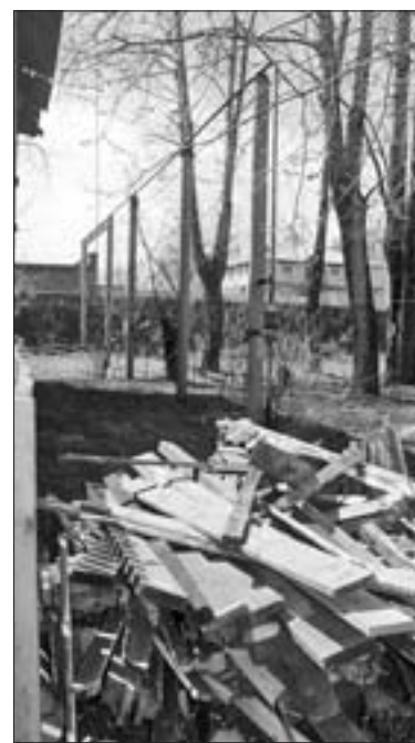
Пожароопасная свалка под газопроводом
